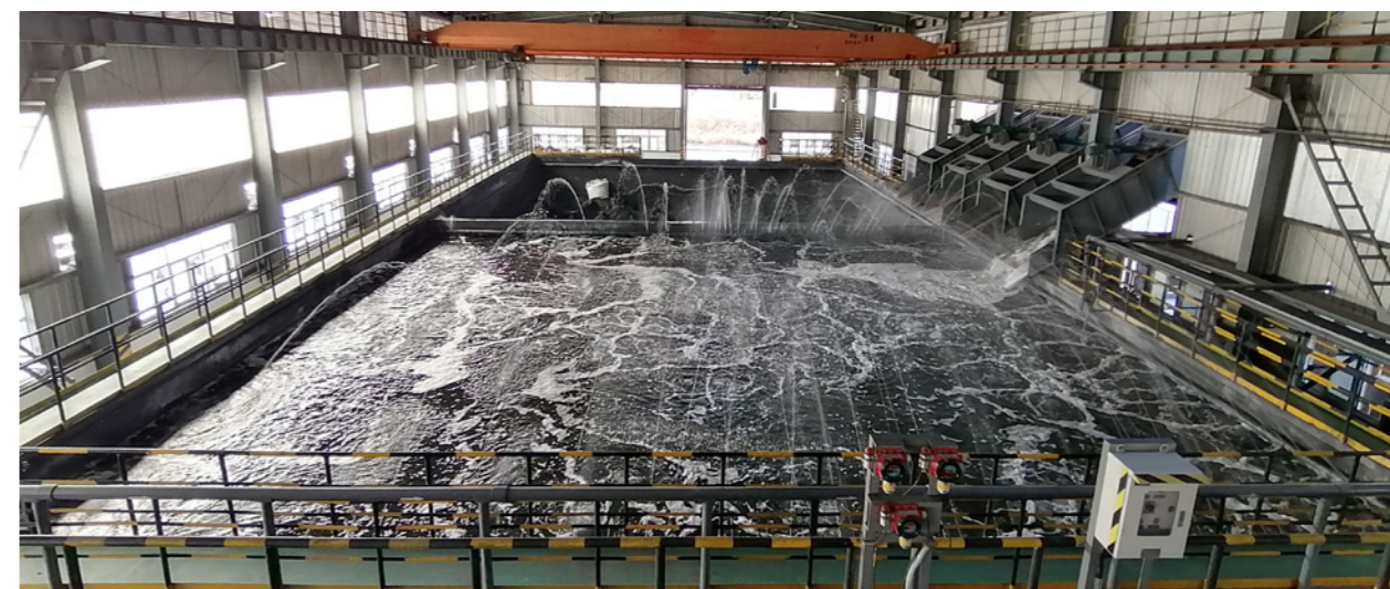
云铝润鑫铝电解废槽衬资源化综合利用关键技术研究及产业示范项目浸出工序
