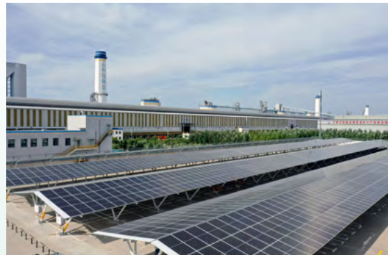
华云电解一厂停车场分布式光伏发电系统
